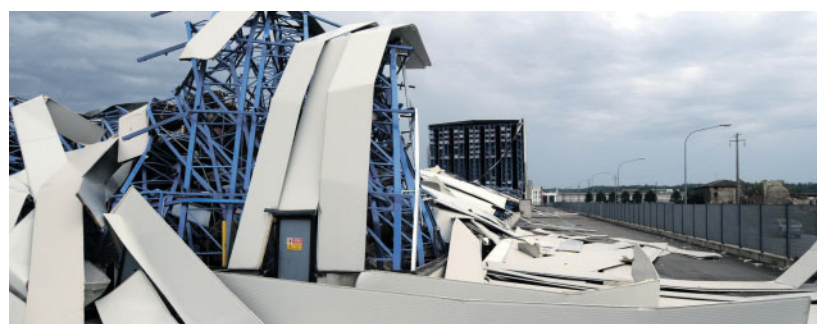
Fabbrica crollata a Sant'Agostino FOTO LAPRESSE
