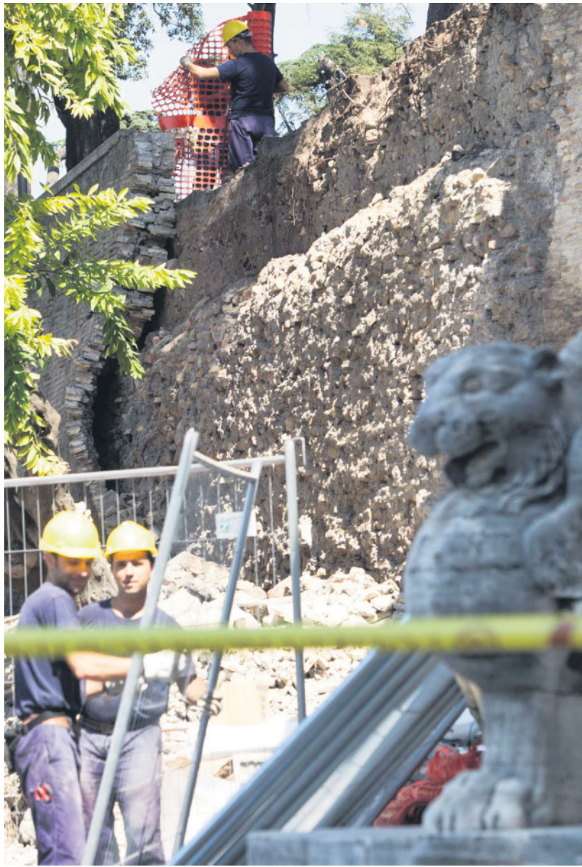
I calcinacci del rivestimento di un muro del Pincio, opera del Valadier FOTO CARCONI/ANSA
