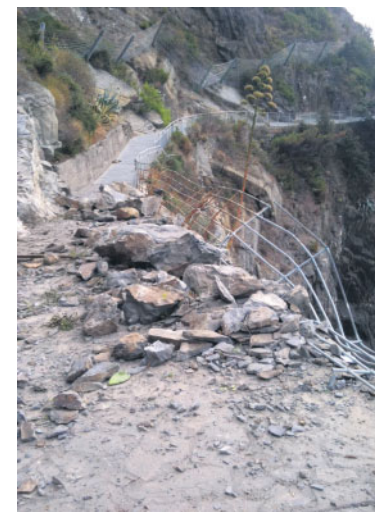
La frana sulla Via dell'Amore nelle Cinque Terre FOTO ANSA
