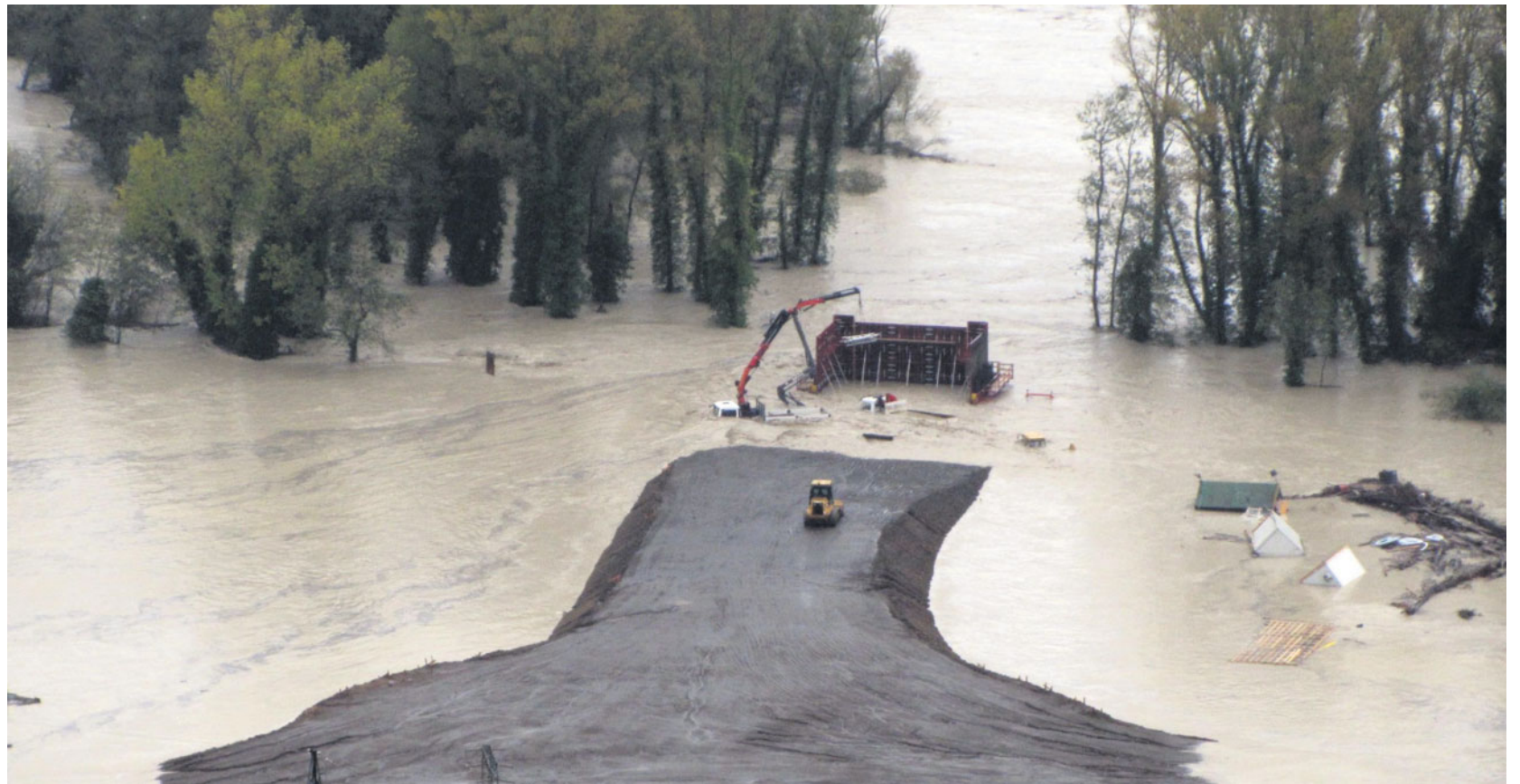
Un cantiere sommerso dall'acqua ad Orvieto FOTO ANSA
