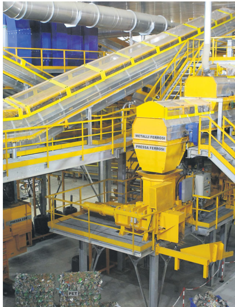
L'area trattamento meccanico biologico della discarica di Malagrotta FOTO LAPRESSE
