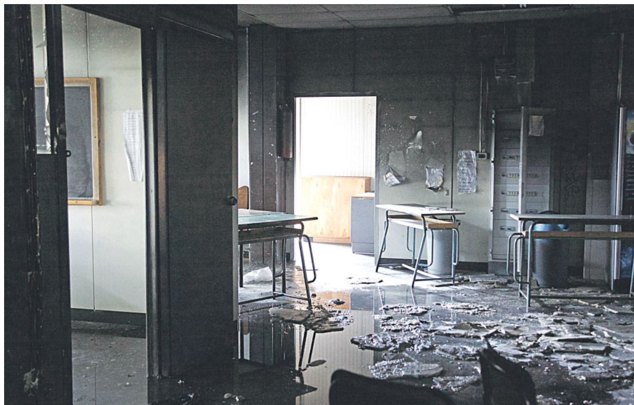
Le aule devastate dalle fiamme al liceo ginnasio Socrate, nel quartiere Garbatella/FOTO LAPRESSE
