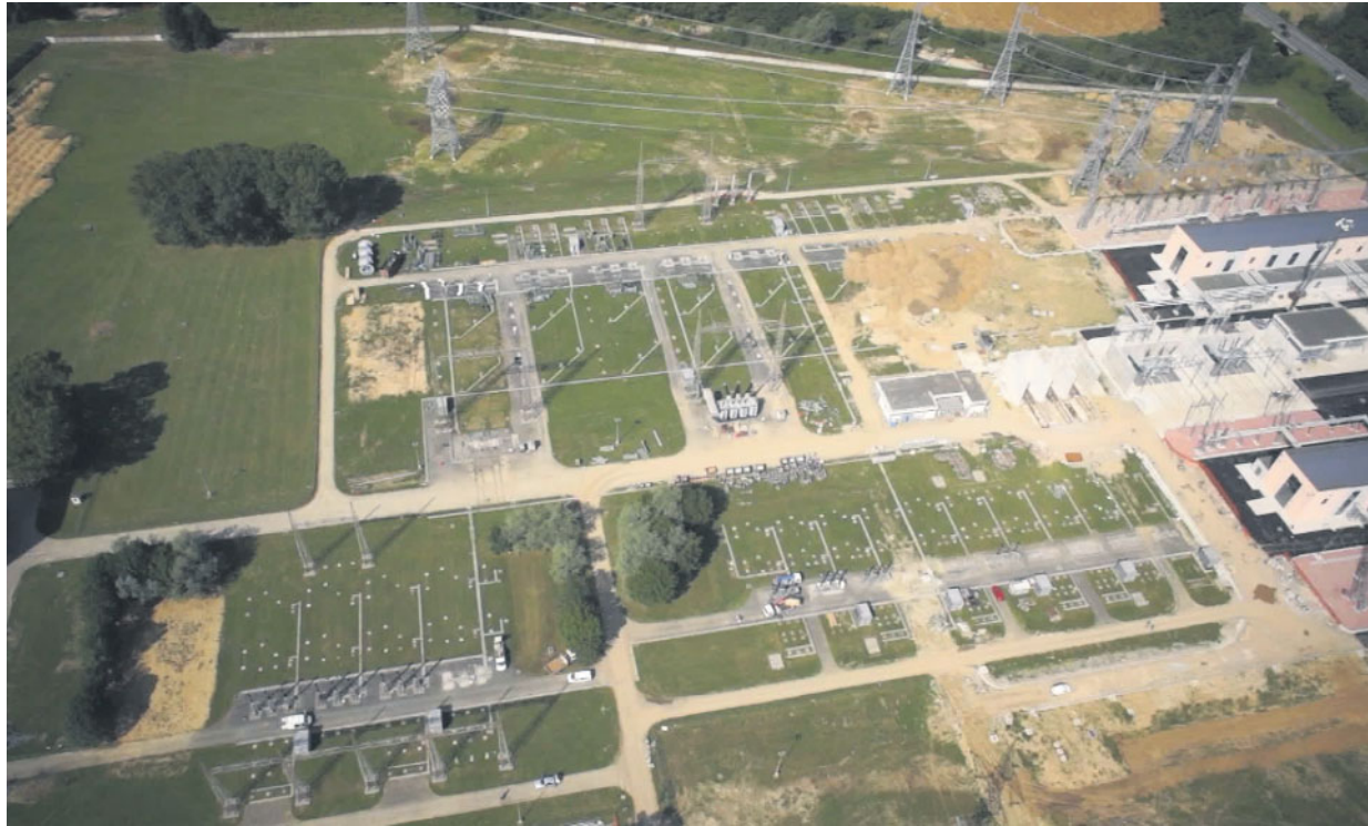
Una veduta area della centrale elettrica di Piosasco
