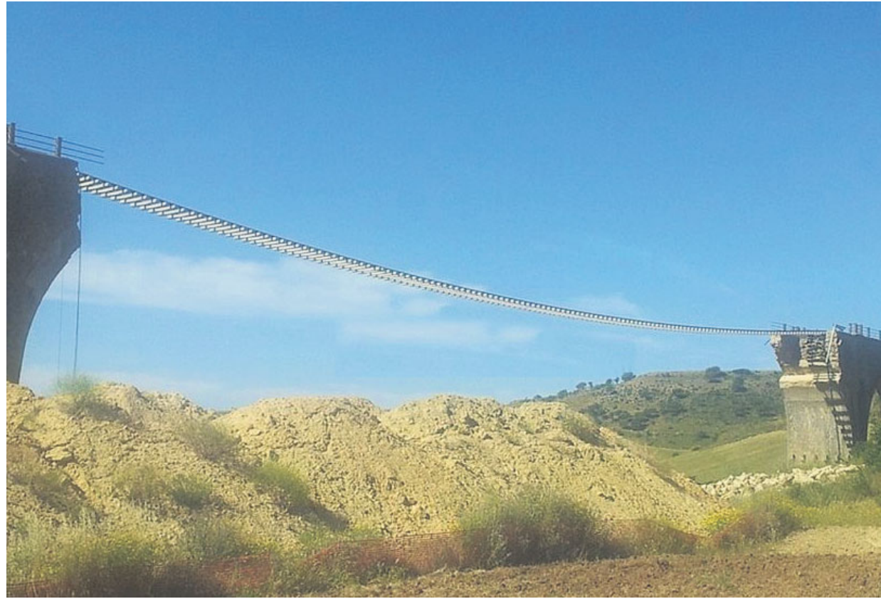
Nella foto il ponte ferroviario della Caltagirone-Gela crollato due anni fa e ancora non riparato FOTO COMITATO PENDOLARI SICILIANI
