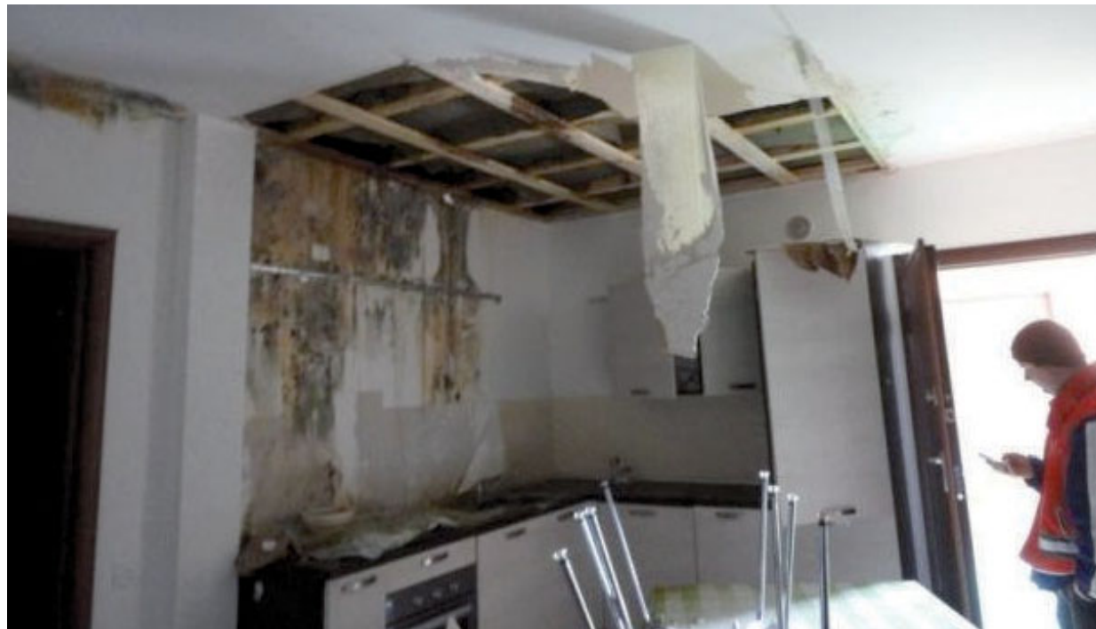
L'interno di un modulo abitativo prefabbricato (map) che sta cadendo a pezzi FOTO FACEBOOK
