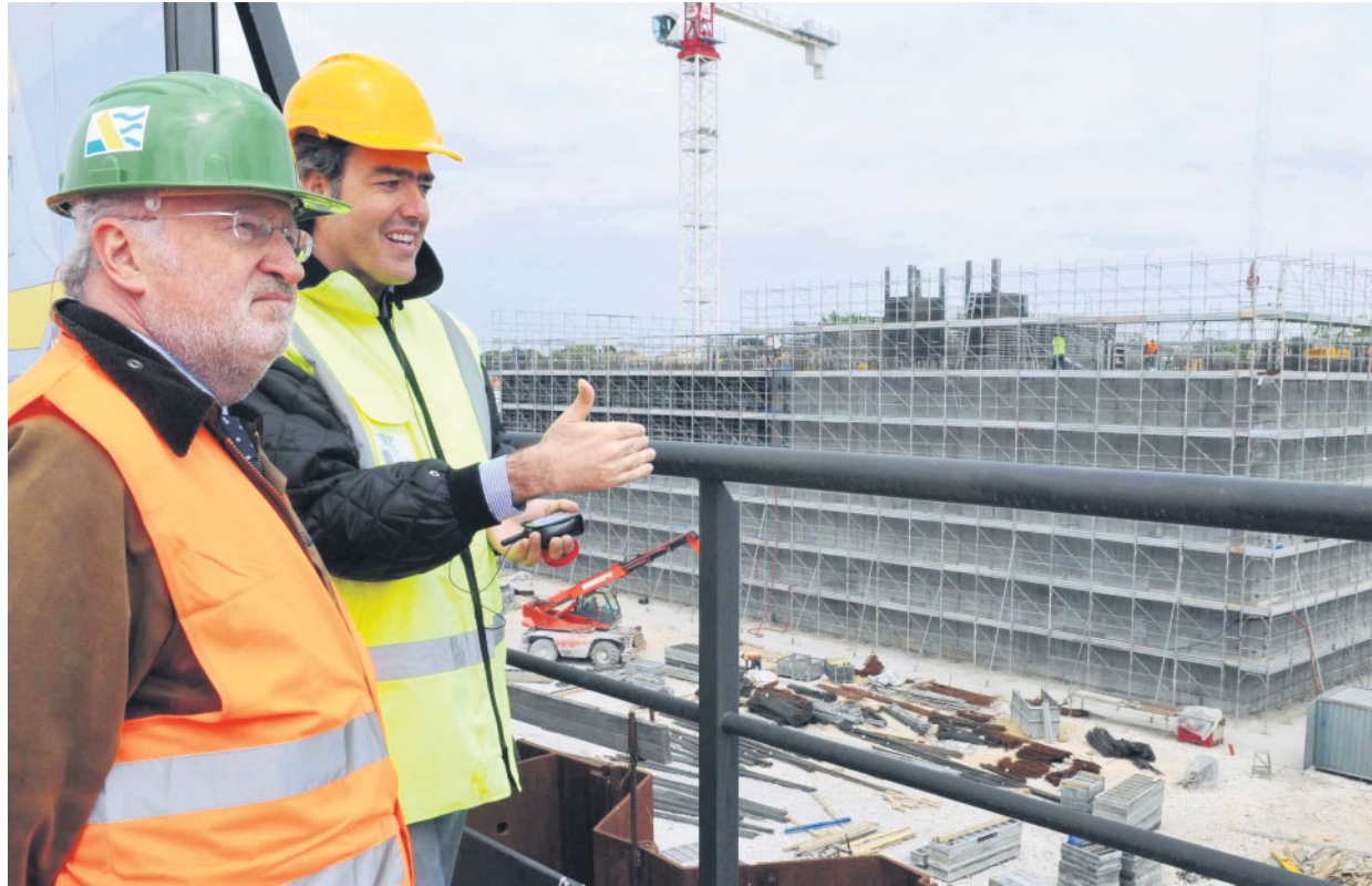
Il sindaco di Venezia Giorgio Orsoni in visita ai cantieri del Mose FOTO VISION/INFOPHOTO
