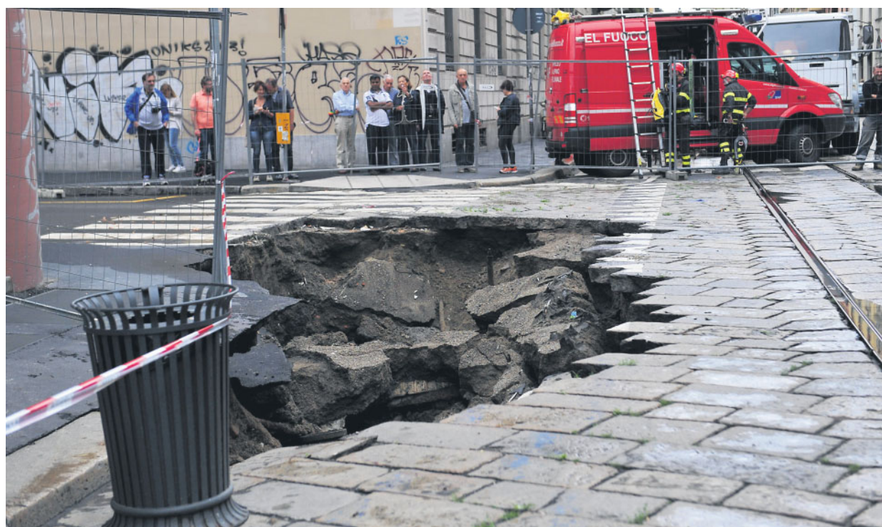
La voragine che si è aperta in corso di Porta Romana a Milano FOTO MATTEINI/INFOPHOTO
