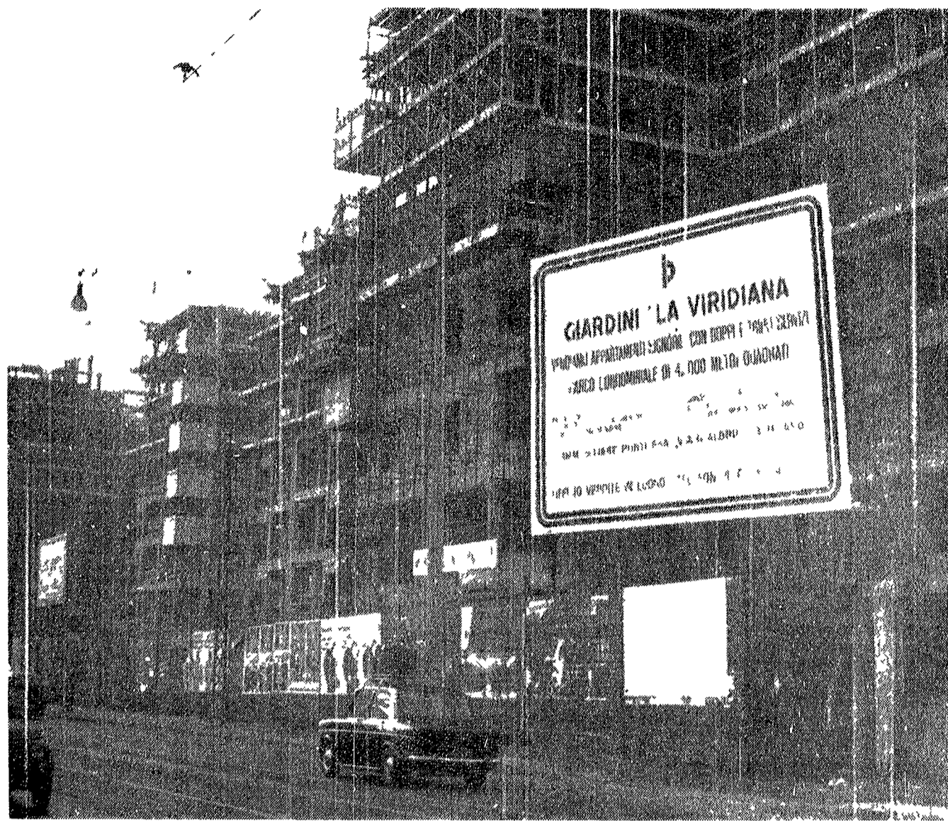
I palazzi della immobiliare Viridiana costruiti in contrasto con il Piano regolatore secondo le privatissime regole del «rito ambrosiano». Il consiglio di zona ha fatto ricorso al ministero dei Lavori Pubblici
