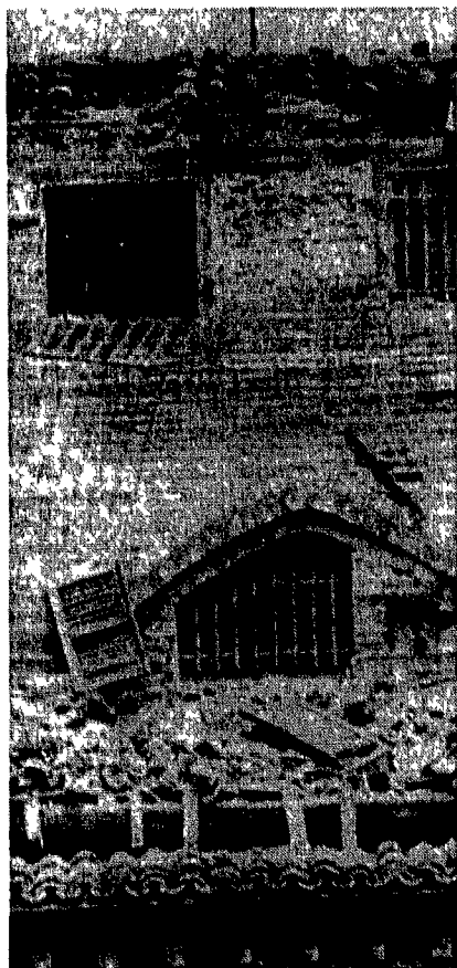
Il tetto crollato di una vecchia casa
