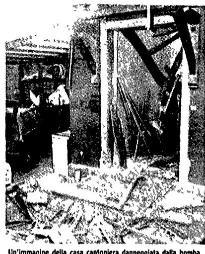
Un'immagine della casa cantoniera danneggiata dalla bomba
