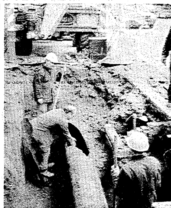
I tecnici controllano la tubatura rotta
