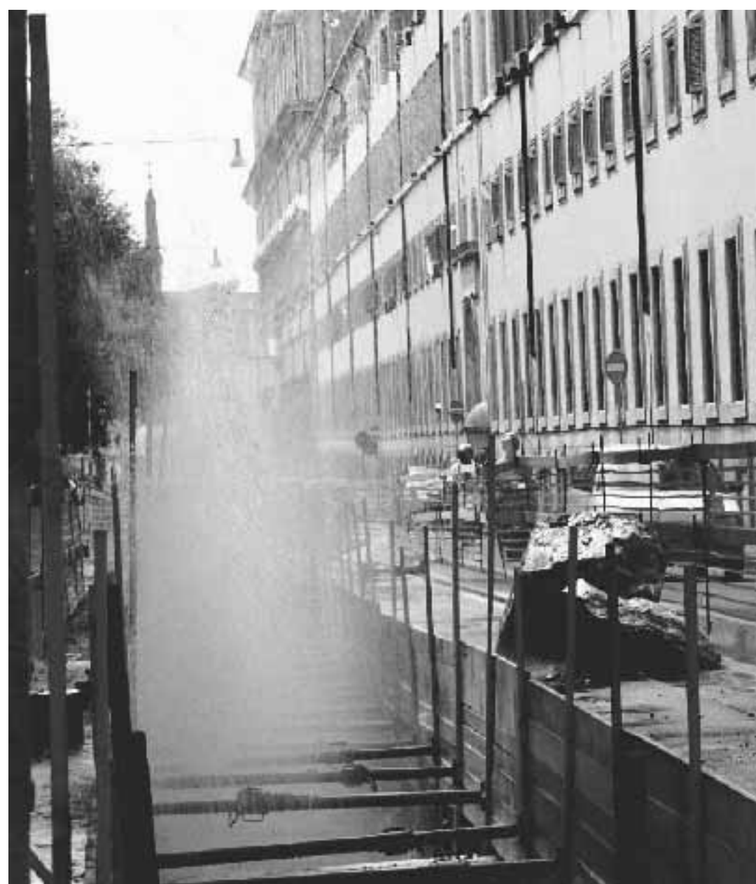
La tubatura idrica rotta durante i lavori in via del Quirinale
