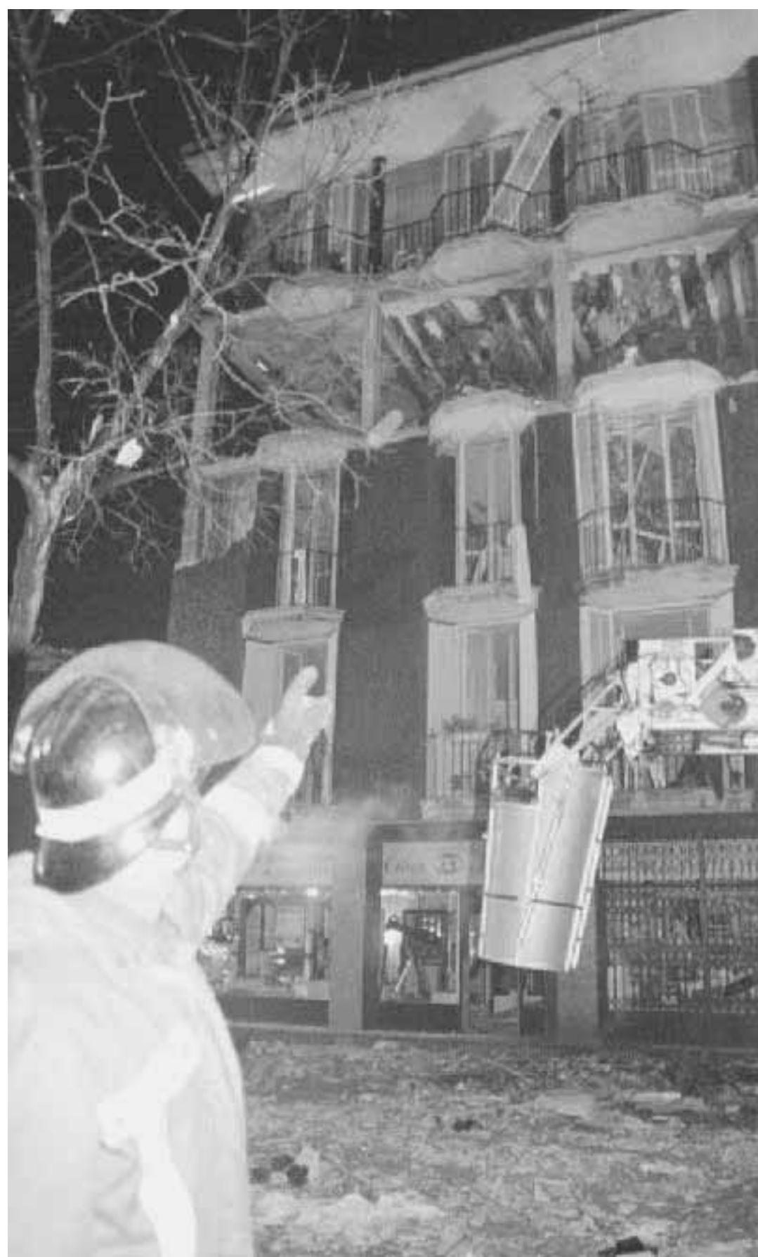
Vigili del fuoco al lavoro davanti al palazzo di Sannazzaro de' Burgondi devastato dall'esplosione di gas
