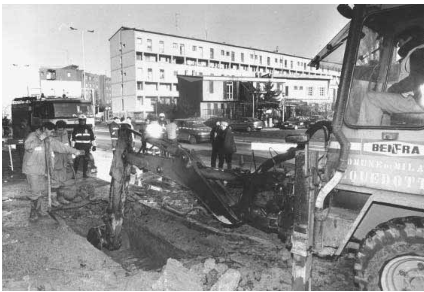
L'intervento dei pompieri in via Novara dopo la rottura di una tubatura dell'acquedotto
