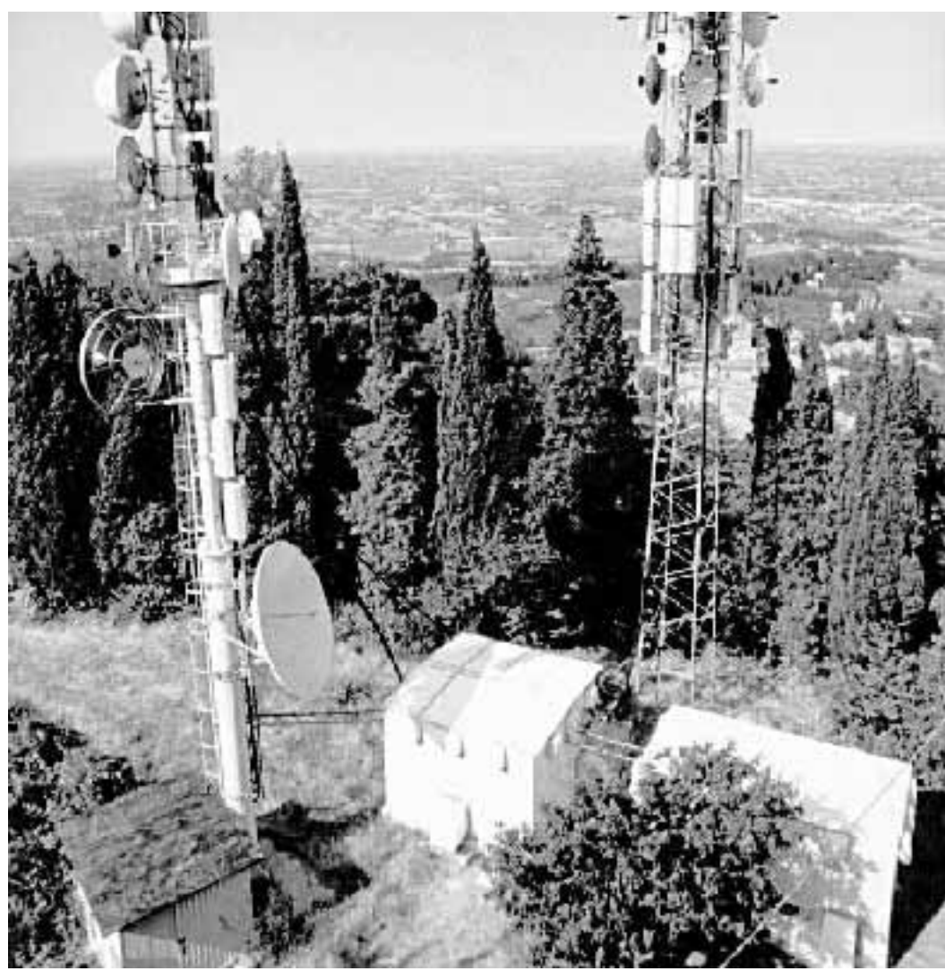
Ripetitori e antenne di telecomunicazione della Telecom
