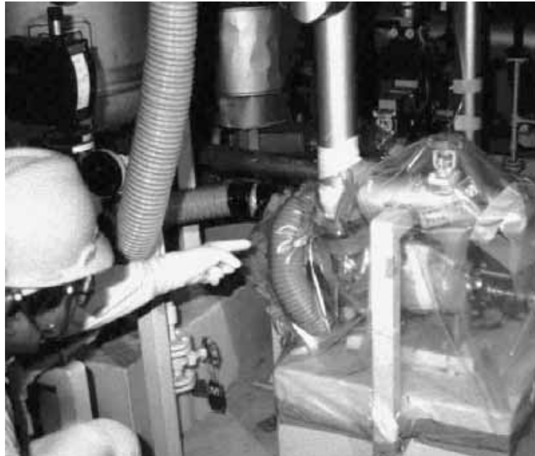
Un tecnico indica la pompa danneggiata del reattore della centrale nucleare di Tsuruga Kyodo/Ap
