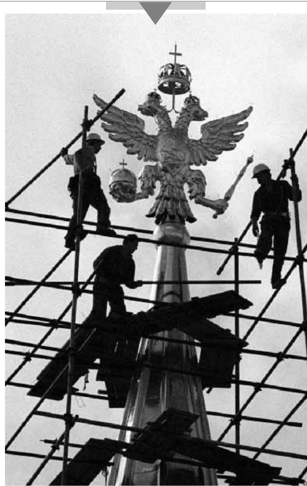
MOSCA. Al Museo storico di Mosca gli operai rimuovono le impalcature dopo aver assicurato la storica aquila a due teste sulla cima della torre. La febbre dei lavori di costruzione e restauro ha contagiato la capitale russa in vista delle celebrazioni per gli 850 anni della città.
