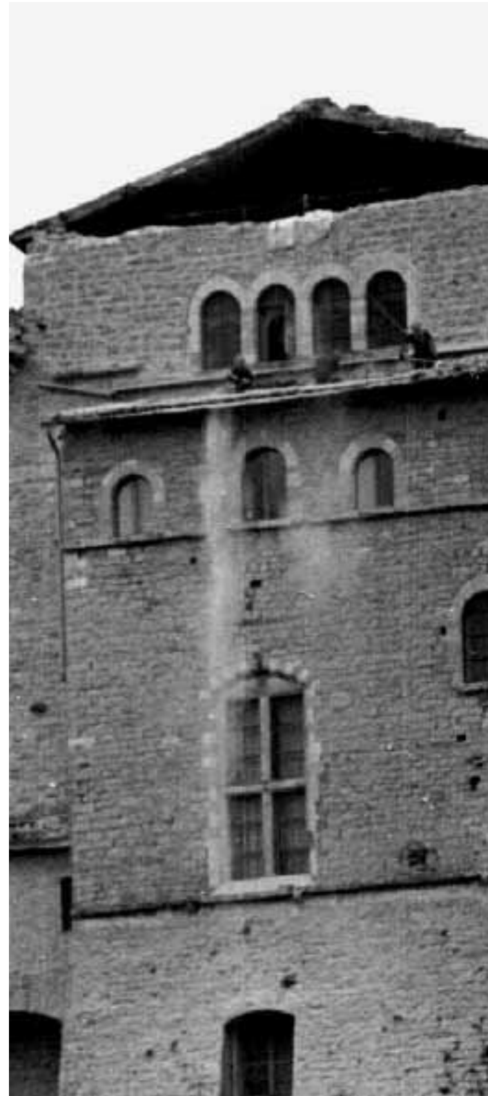
I vigili del fuoco tolgono le macerie dal tetto della Basilica di Assisi Medici/Ansa
