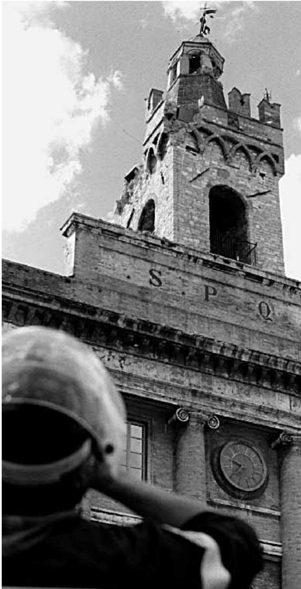
Un vigile del fuoco controlla il cornicione della torre del palazzo comunale di Foligno Monteforte/Ansa
