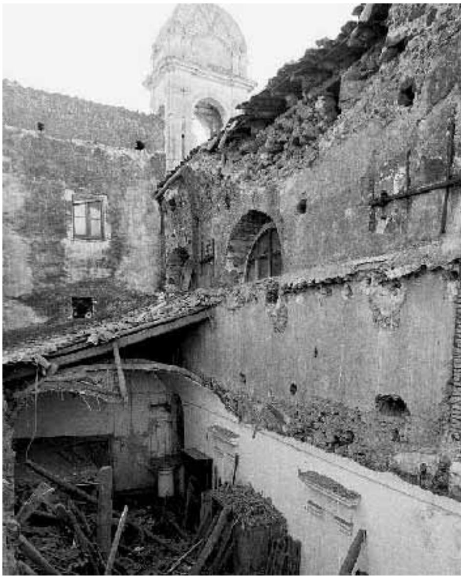
Il crollo del tetto della chiesa della Madonna del Rosario di Biancavilla
