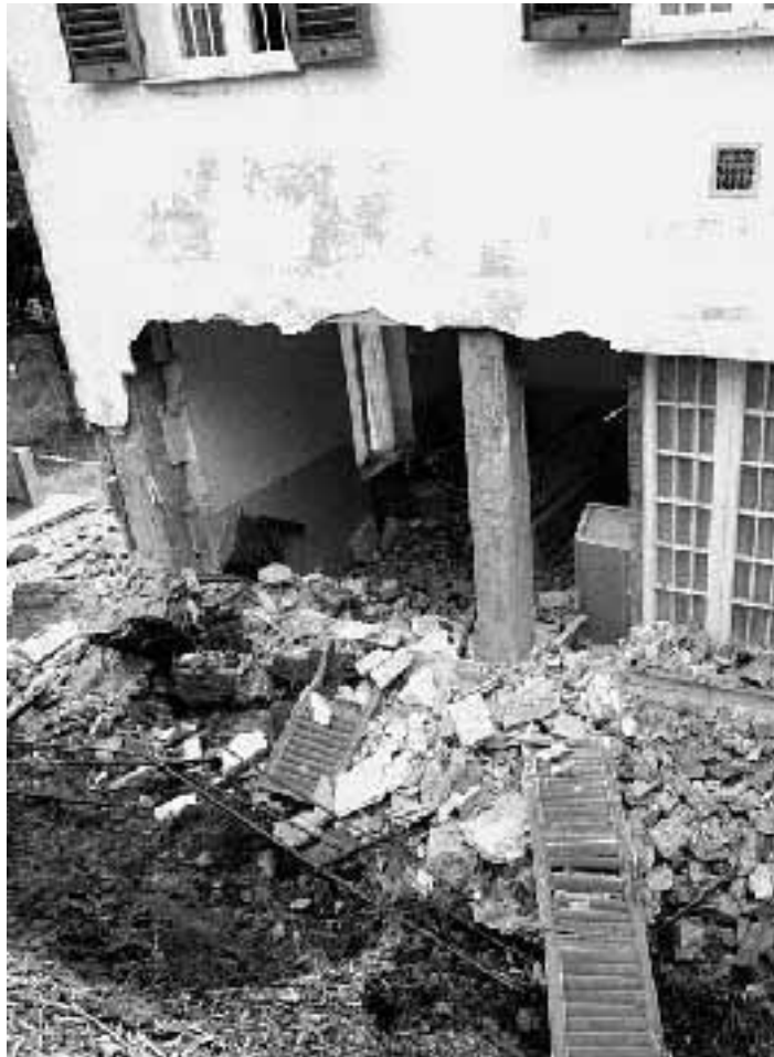
I danni causati dal crollo a Cogoleto
