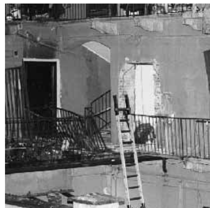
Rosanna Caprilli La casa di ringhiera distrutta dall'esplosione
