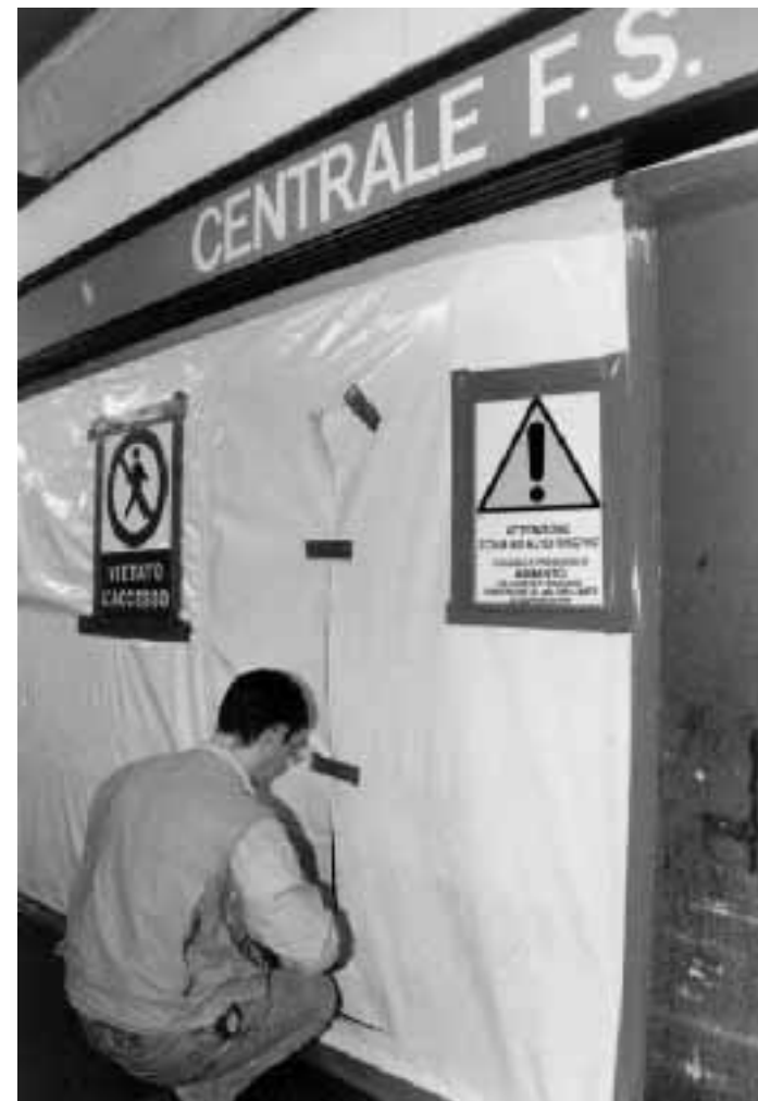
La fermata della Centrale sarà bonificata dall'amianto
