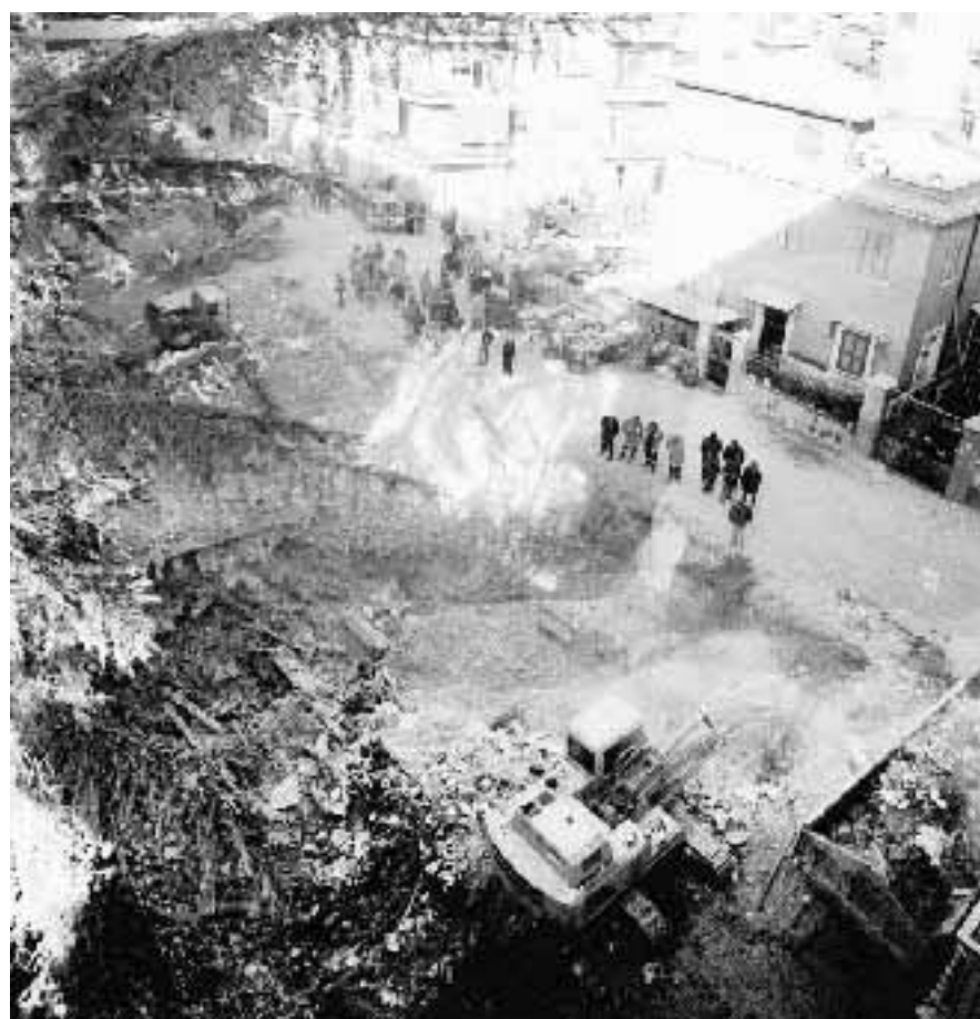
Una panoramica delle macerie dell'edificio crollato a Roma
