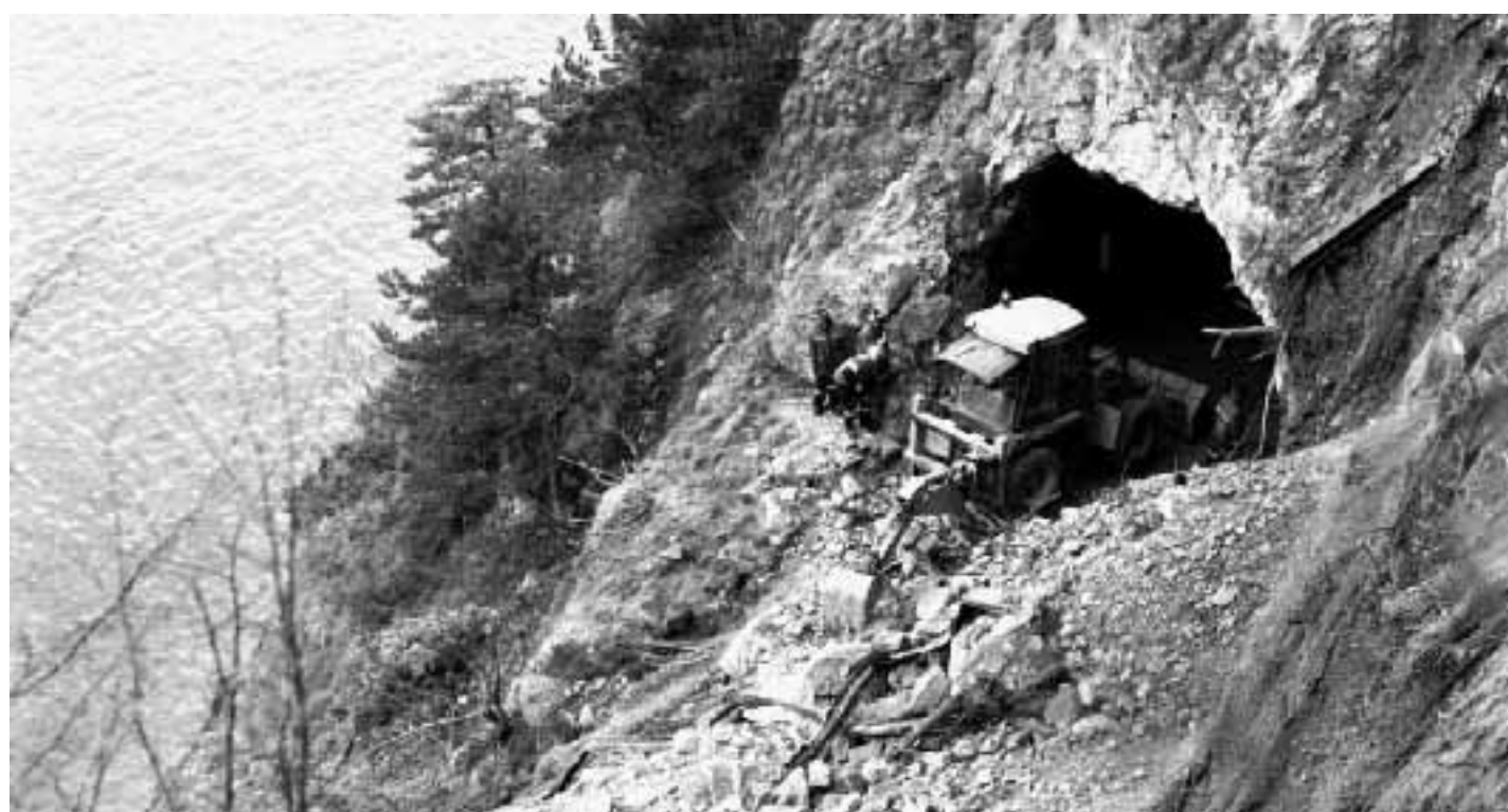
Si continua a scavare sul luogo della frana a Riva del Garda
