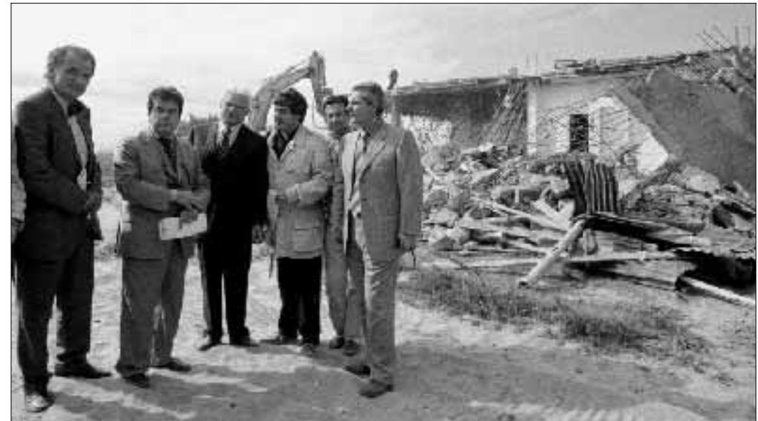
Il sindaco di Catania Enzo Bianco, durante i lavori di demolizione delle case abusive nell'oasi del Simeto S. Ragonesi/Ansa
