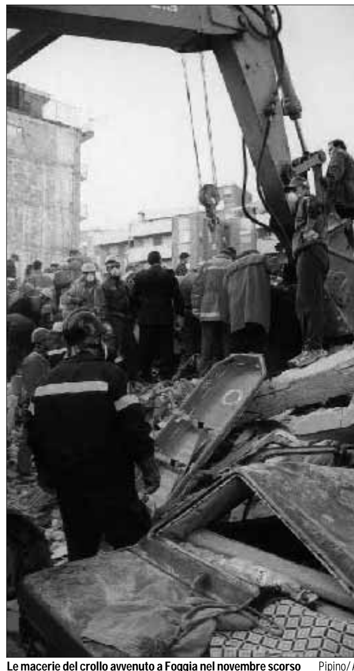
Le macerie del crollo avvenuto a Foggia nel novembre scorso. Pipino/Ag
