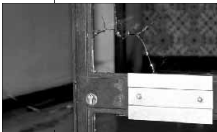
La porta d'ingresso dello stabile, sfondata da un sasso
