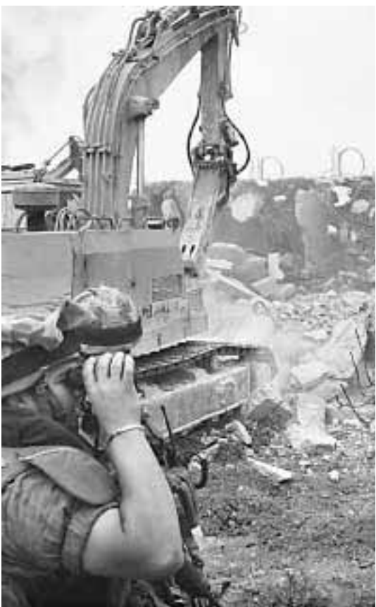
Soldati israeliani controllano la demolizione di case nella zona di Hebron. H. Abu Alan/Ansa
