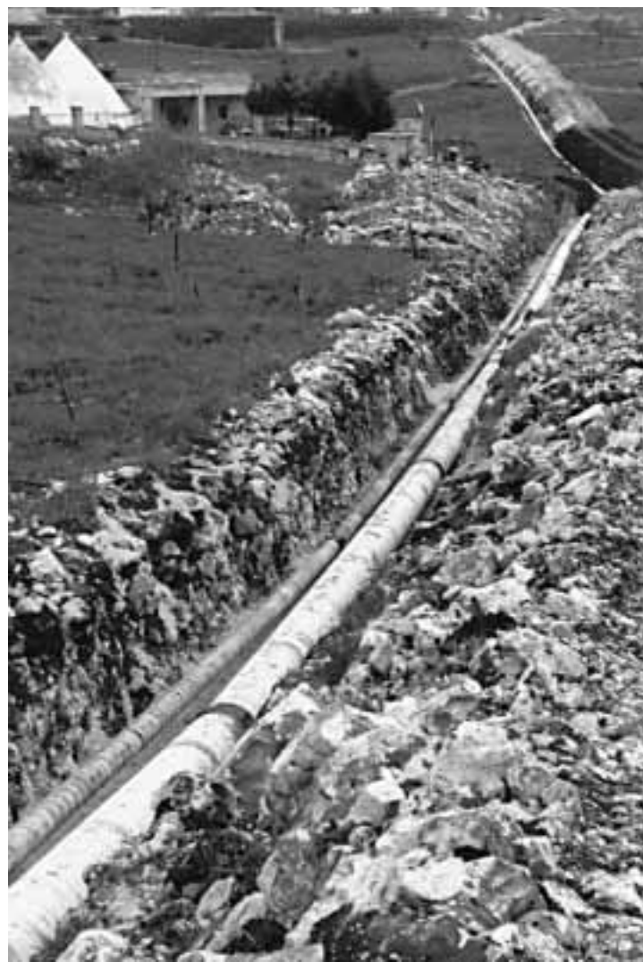
Condotte di distribuzione nella zona di Martina Franca
