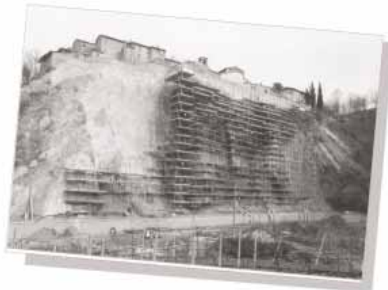
Consolidamento parete rocciosa a salvaguardia dell'abitato di Linaro (FO) (Ancoraggi - tiranti e spritz-beton)
