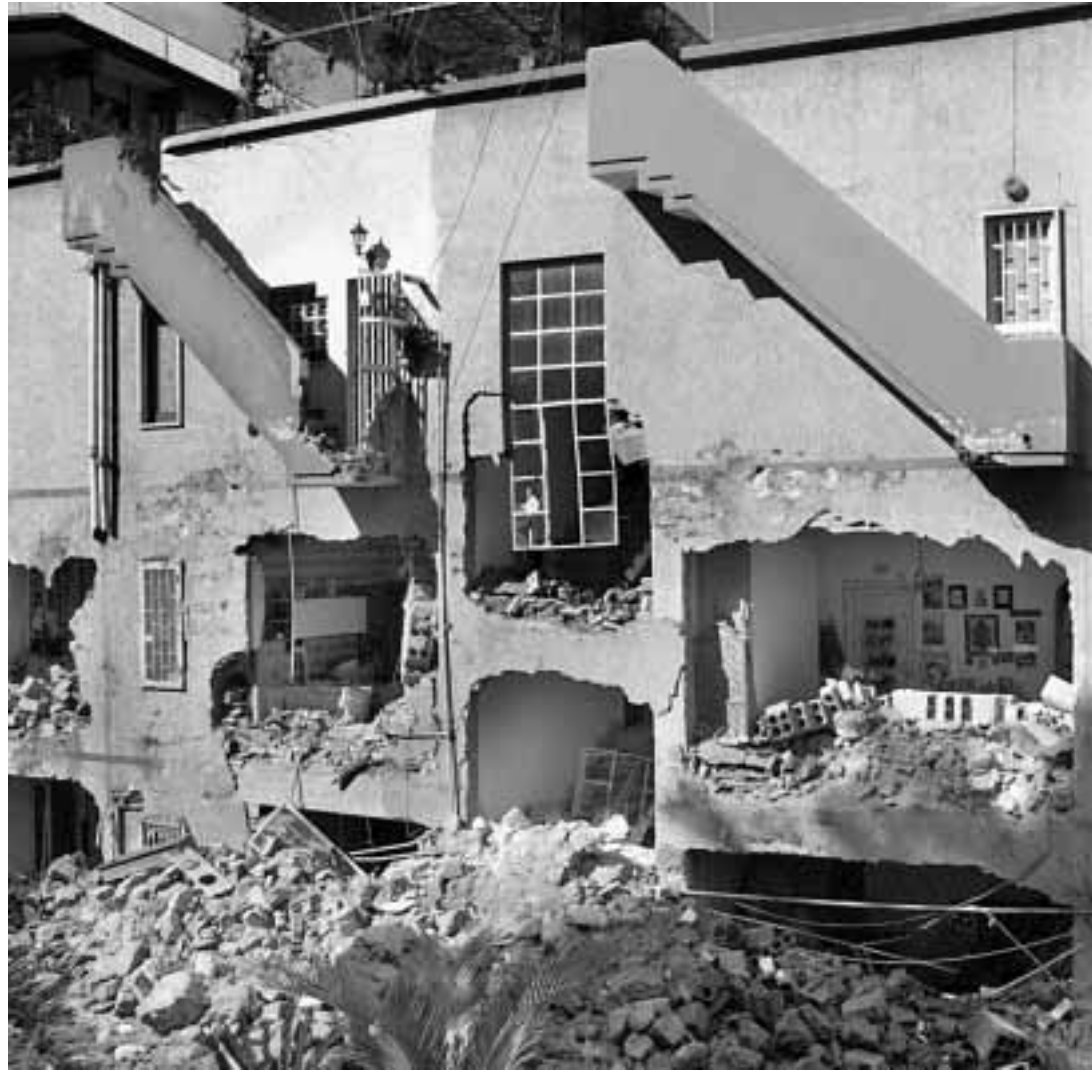
Un palazzo a Napoli parzialmente distrutto dal nubifragio
