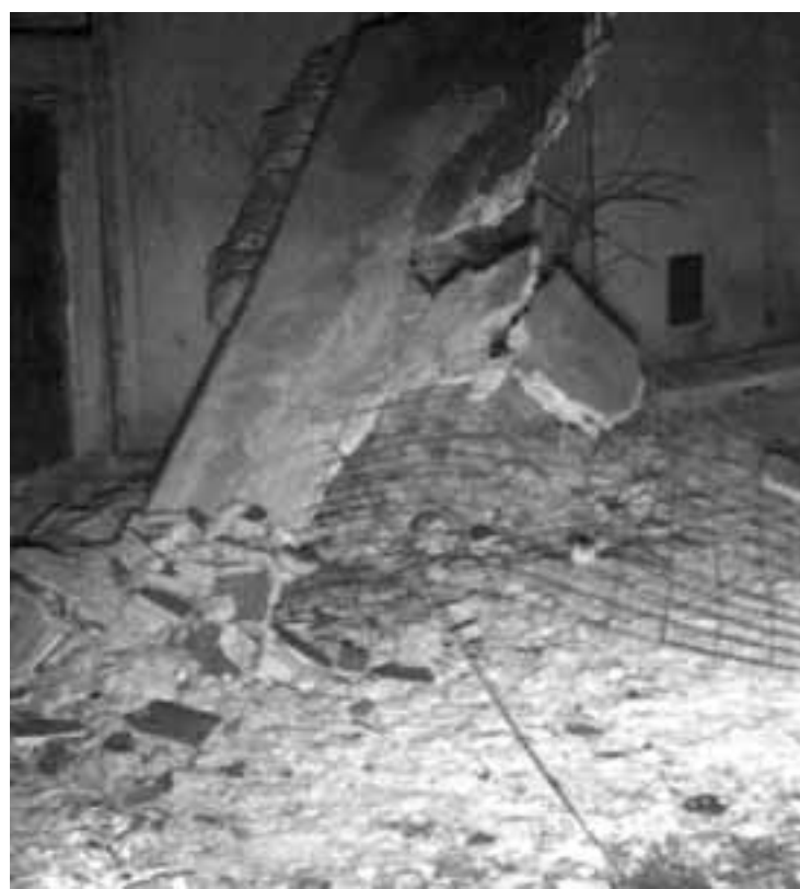
Una parte della galleria caduta dopo l'impatto tra i due camion
