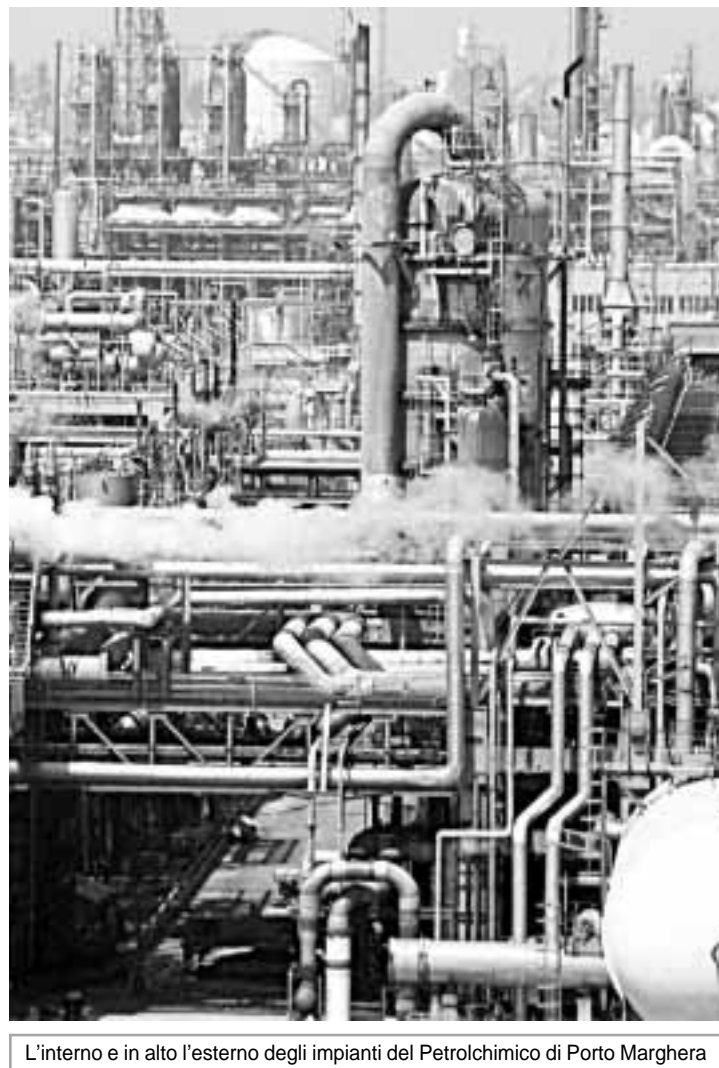
L'interno e in alto l'esterno degli impianti del Petrolchimico di Porto Marghera
