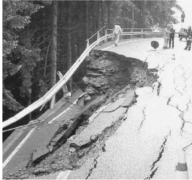
Una frana provocata dalle piogge in Vaitellina
