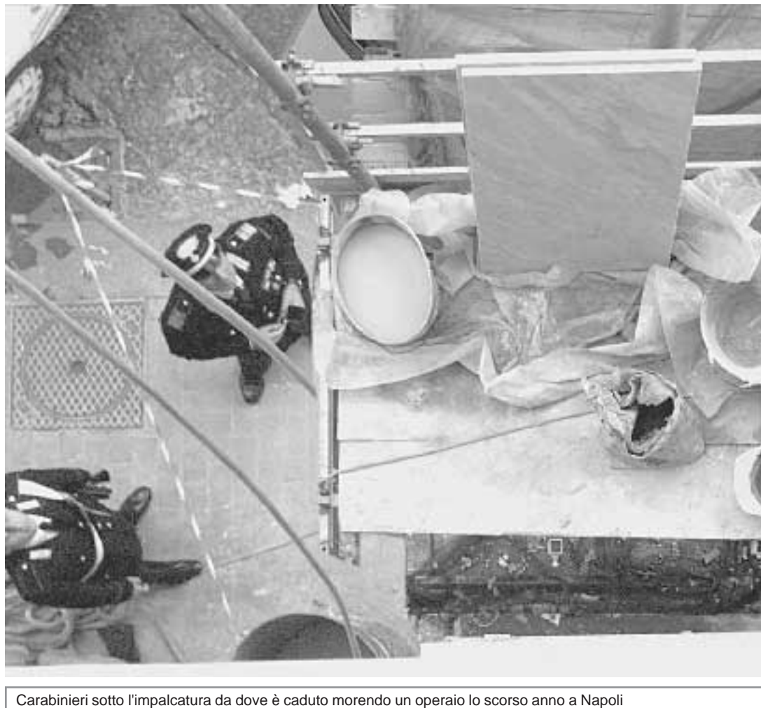
Carabinieri sotto l'impalcatura da dove è caduto morendo un operaio lo scorso anno a Napoli
