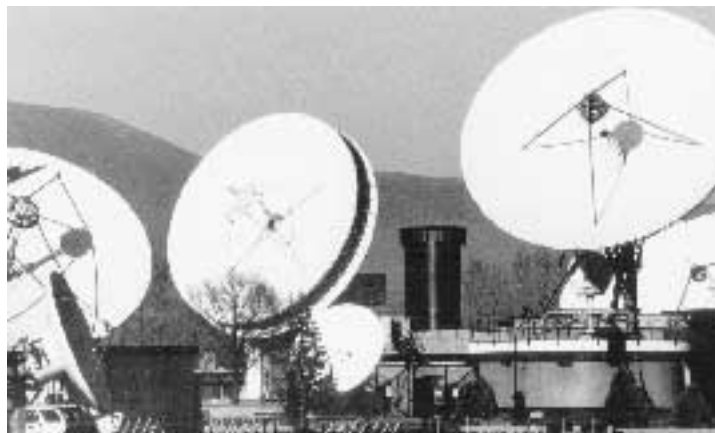
Una centrale per la ricezione e trasmissione televisiva via satellite
