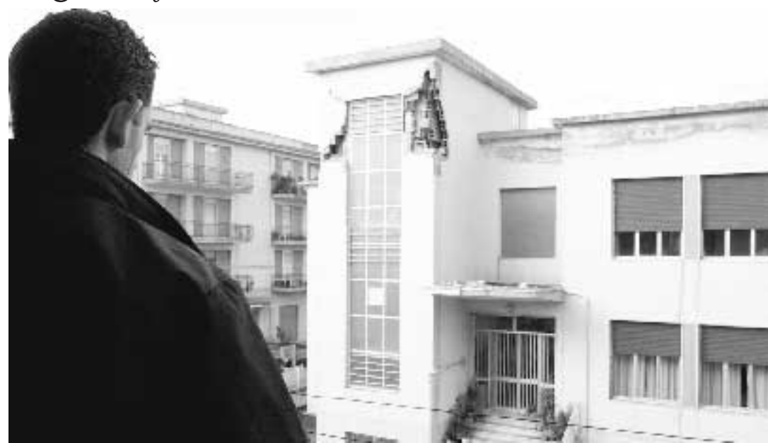
La scuola Manzoni di Giarre dopo le due scosse di terremoto
