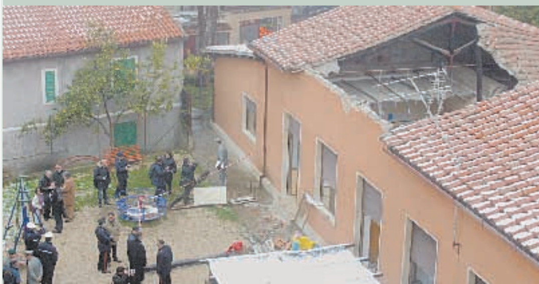
Il tetto crollato della scuola di Montelibretti vicino Roma
