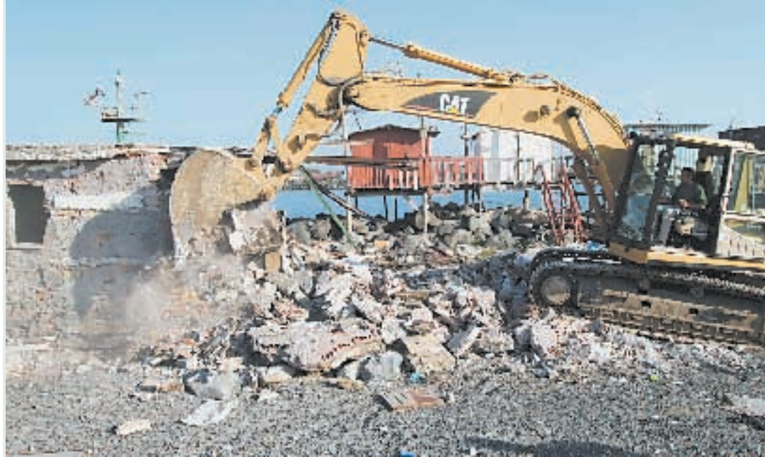
Ostia, ore 11 di ieri: il sindaco di Roma fa demolire una costruzione abusiva. Andrea Sabbadini
