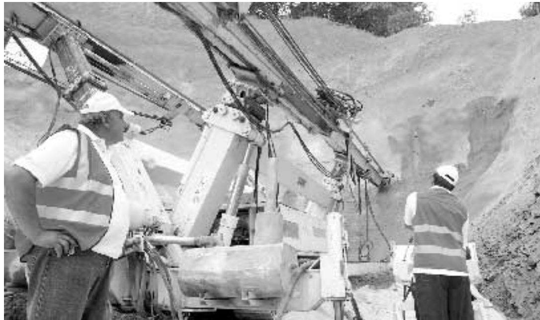
Operai all'opera presso i lavori di scavo della nuova galleria della variante di valico a Barberino del Mugello
