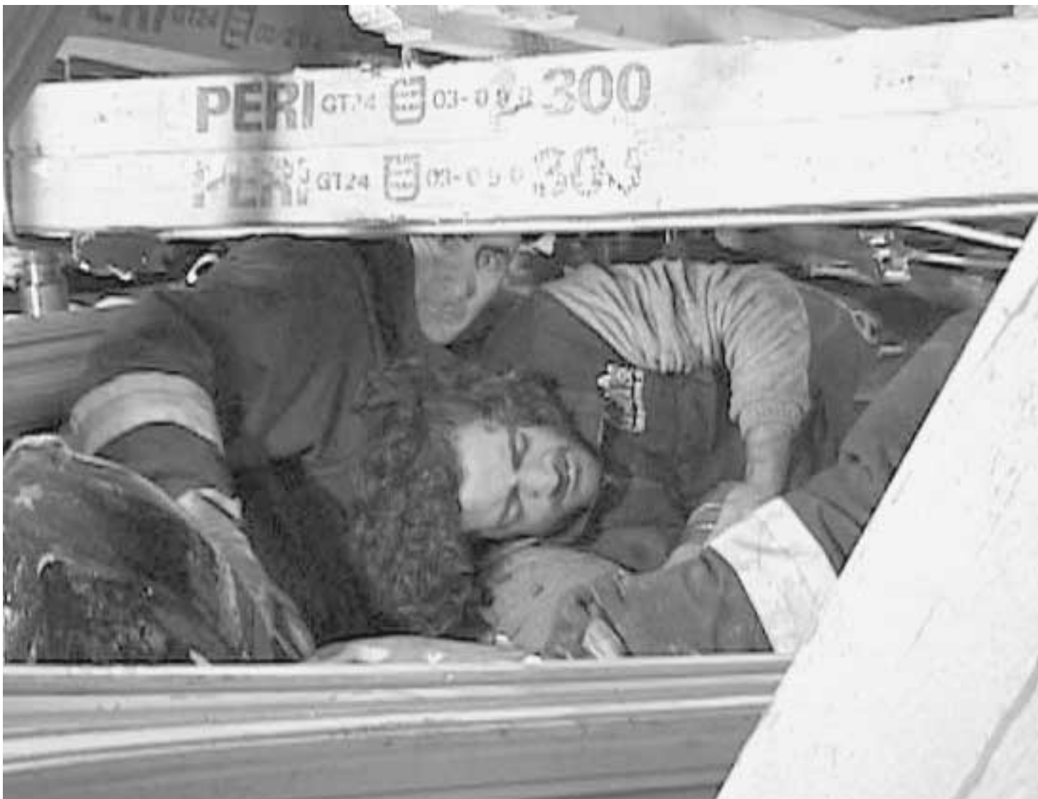
Primi soccorsi ad un ferito nel crollo del palazzo in via di ristrutturazione ieri a Genova
