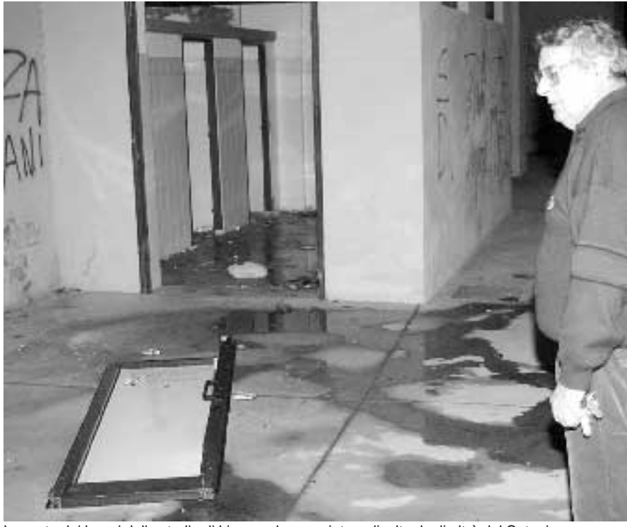
Le porte dei bagni dello stadio di Livorno danneggiate e divelte dagli ultrà del Catania
