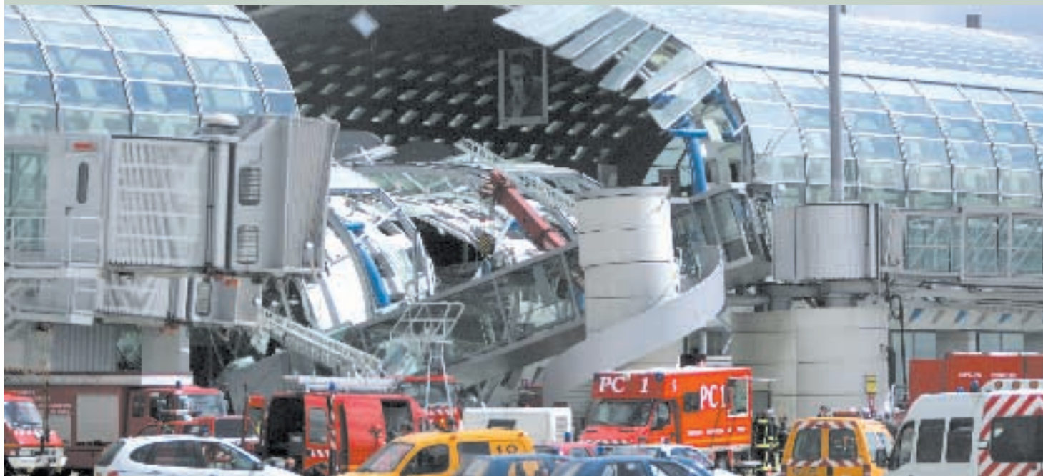
Il tetto crollato all'aeroporto di Parigi-Roissy-Charles De Gaulle
