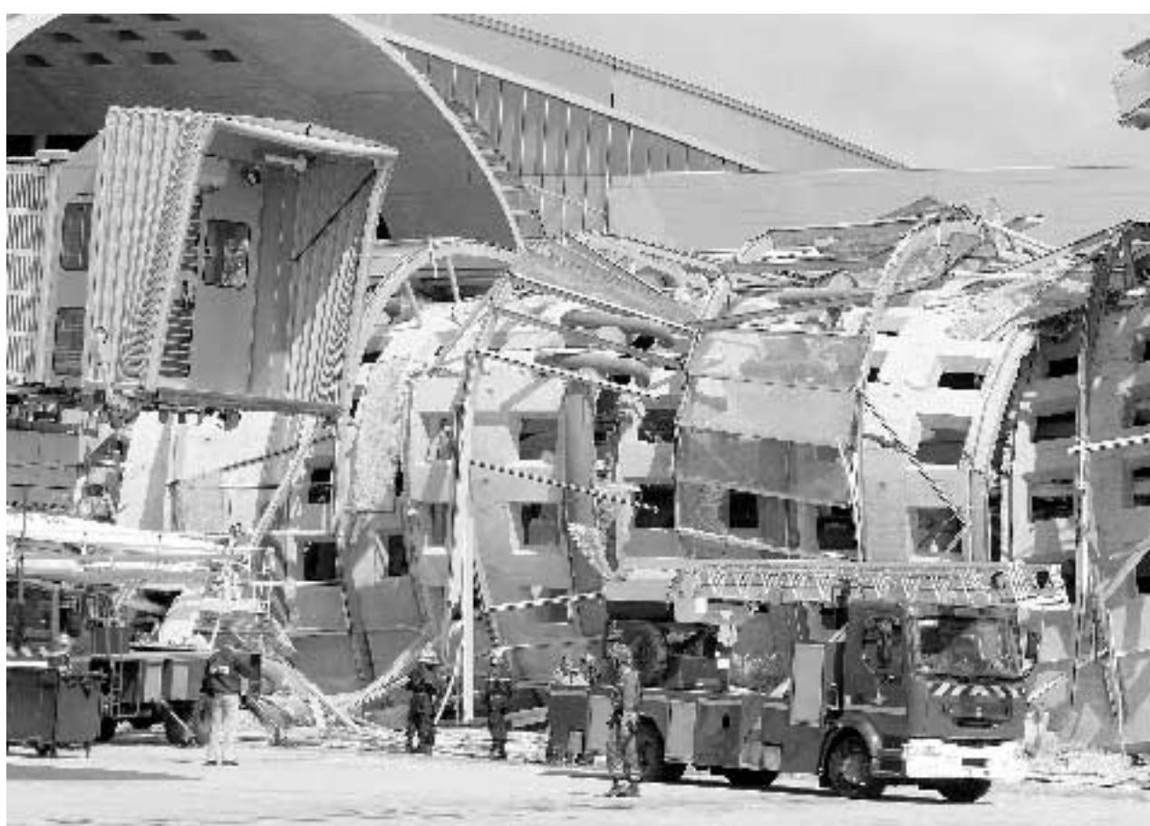
Il crollo del nuovo terminal dell'aeroporto parigino Charles de Gaulle
