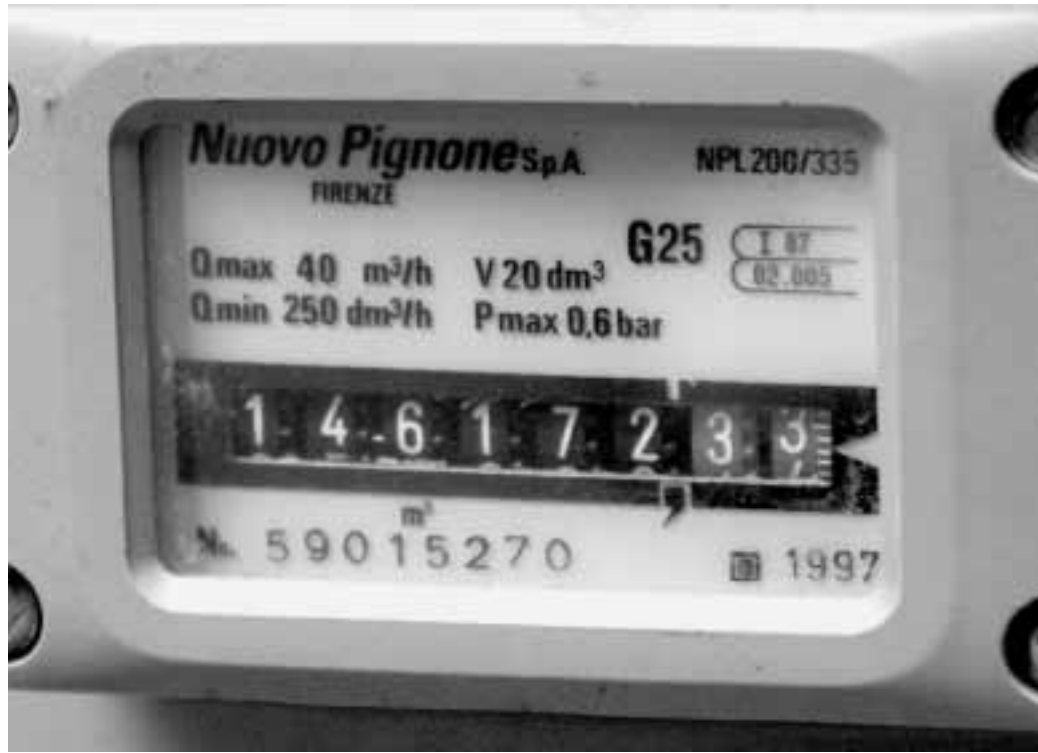
Il quadrante di un contatore del gas
